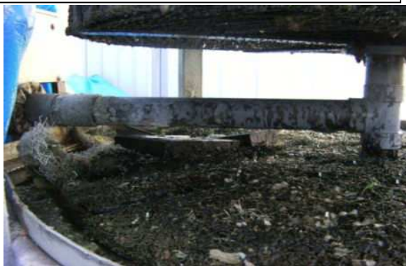
フィルターと塩ビの配管は藻が付着し緑色である。
