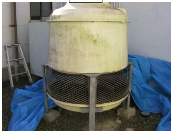
全体的に汚れが付着している。
