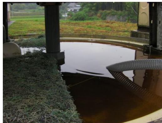
クーリングタワーの循環を停止した画像 ↑
