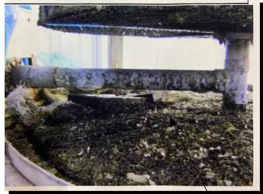
フィルターに混合スケールが付着している画像
