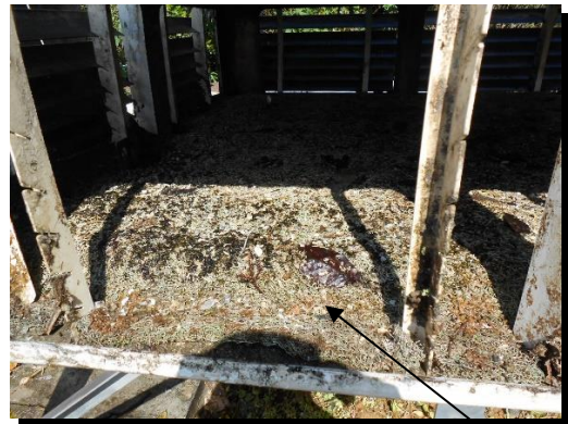
クーリングタワー内部のフィルター カルシウムスケールが、付着している画像
